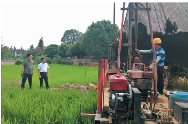
2022 年 8 月,许家桥回族维吾尔族乡中堰村抗旱打机井现场 (提供:杨敏)
