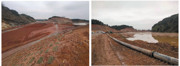
CK04 矿坑北部治理完工 CK04 矿坑采坑南部存在稀泥坑 (提供:郭杰)
